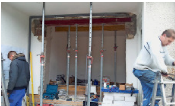
Der Durchbruch zum hinter dem Wintergarten liegenden Wohnraum schafft Licht und eine größere Wohnfläche.
